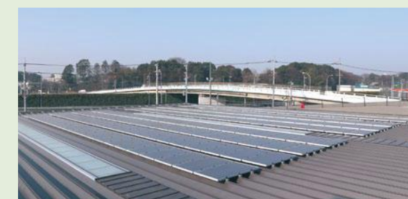
店舗屋上に 配置された ソーラーパネル
