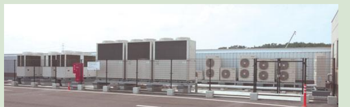
GHP・PACの室外機、冷設用冷凍機が並ぶ屋上階
