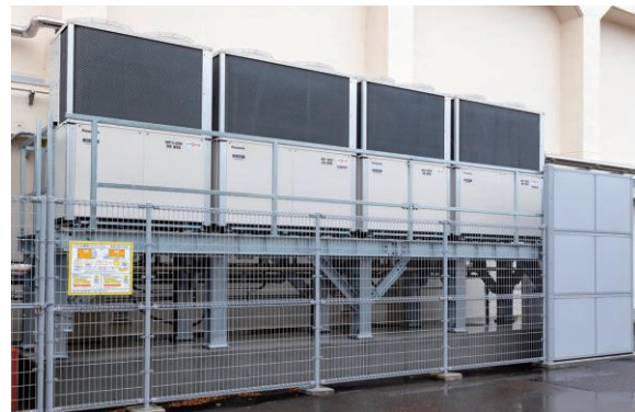
▲水害対策のため1.66mかさ上げされたGHP室外機
