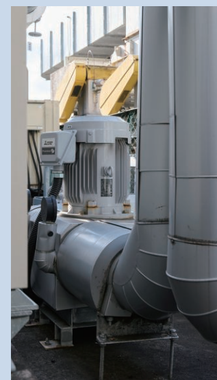
▲冷温水ポンプ
