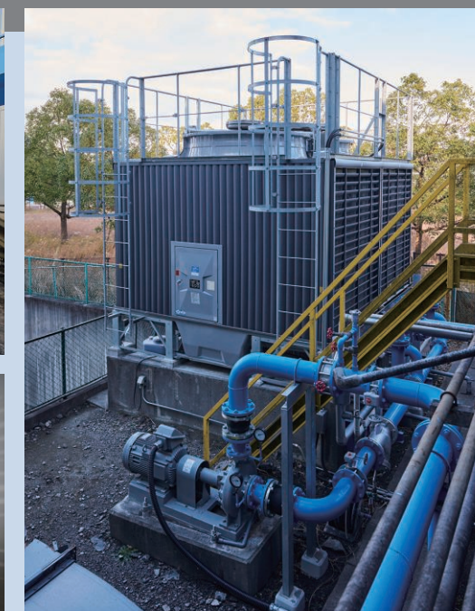
▲冷却塔・冷却水ポンプ
