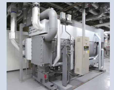
▲CP型ジェネリンクと同時期に設置された 低温水-重効用吸収冷凍機
