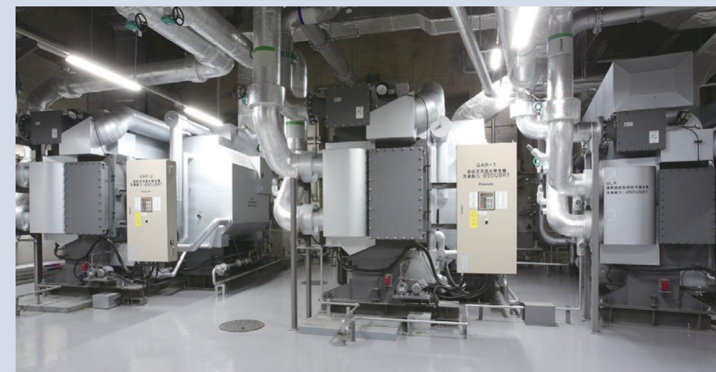
▲研究棟 機械室(右端がCP型ジェネリンク)
