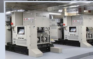
◀発電機からの排熱を利用した コージェネレーションシステムの 排温水を活用
