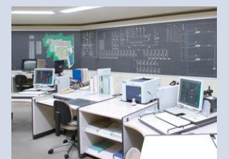
▲エネルギーセンター (中央監視室)
