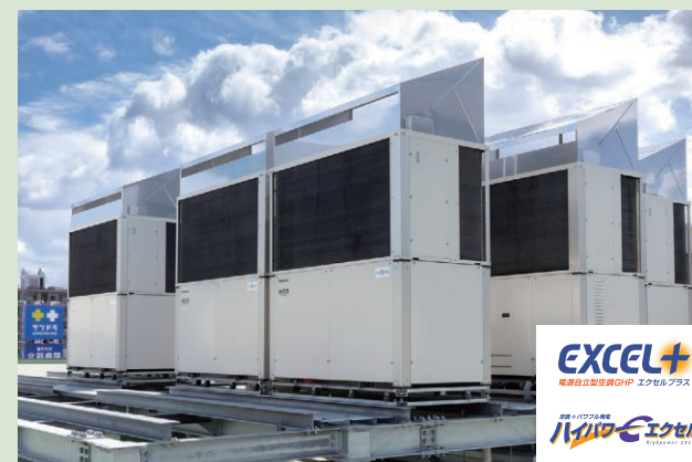
▲屋上に設置された室外機。60馬力分は電源自立型空調機を導入
