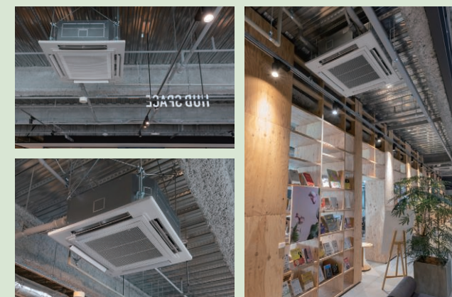
▲2階のEZOHUB SAPPORO内に設置された4方向天井カセット形室内機(ナノイーX標準搭載機)
