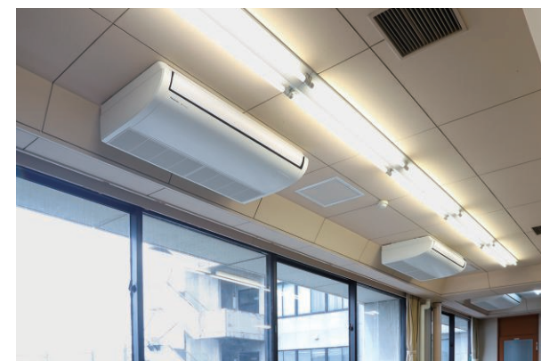
▲事務所に3台並んだ天井吊形(対面にも3台設置)
