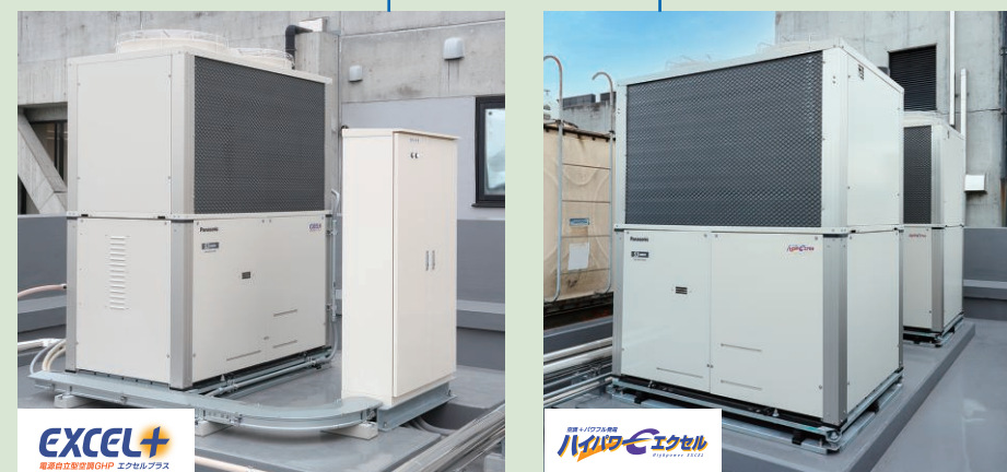
▲屋上に設置されたエクセルプラスとハイパワーエクセルは3台連結の複数台システム(計60馬力)
