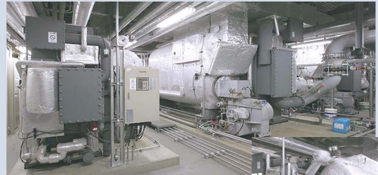
▲東講義実習棟 機械室
