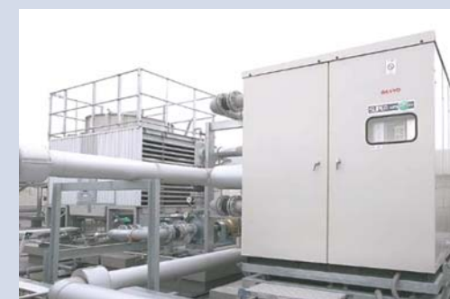
▲西講義実習棟 屋上設置
