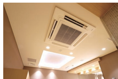
▲大浴場の脱衣場に設置された 4方向天井カセット形室内機。 〔「ナノイーX」機能搭載〕
