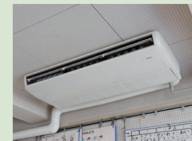
▲天井吊形室内機(越谷市立大沢小学校)
