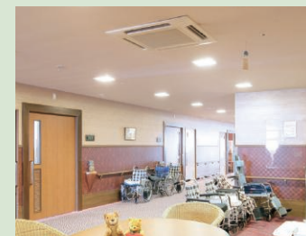
▲共用スペースに導入された 4方向天井カセット形 （「あいあい」内）
