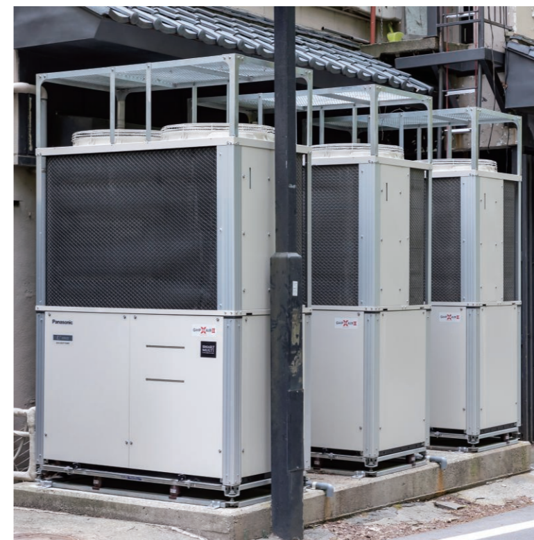
▲建物裏に設置された一体型ハイブリッド空調スマートマルチ。(防雪ネットを設置) 平時の運転では「スタンドアロンモード」で効率運転を実施
