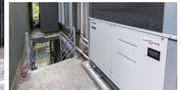
▲すぐ横には非常階段が位置し、設置スペースは限られる。(故障時のバックアップを目的としたWマルチは設置が不可能)
