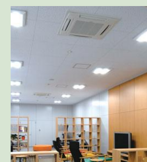
▲レクリエーションルーム (空調・照明・非常用コンセント(100V))
