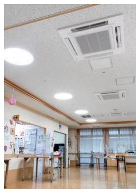
▲廊下に設置された4方向天井カセット形室内機
