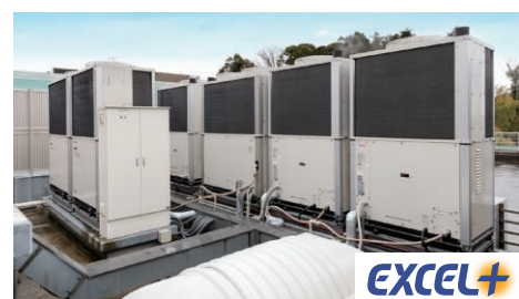
▲室外機(電源自立型空調GHPエクセルプラス・標準マルチ)
