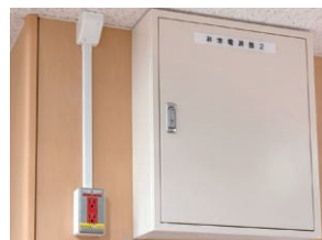
▲壁に設置された非常用電源コンセント
