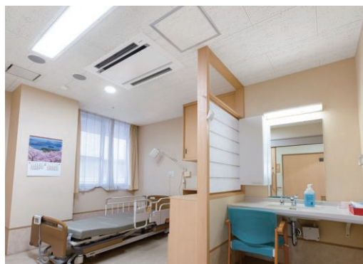
▲居室に設置された2方向天井カセット形室内機
