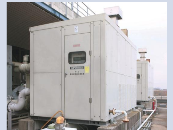
▲北館 ガス焚吸収冷温水機(パネル型)
