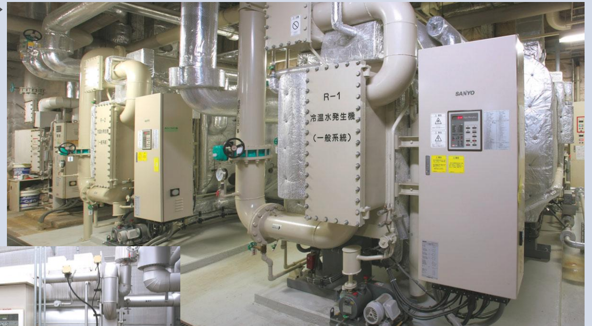
南館▶ ガス吸収冷温水機
