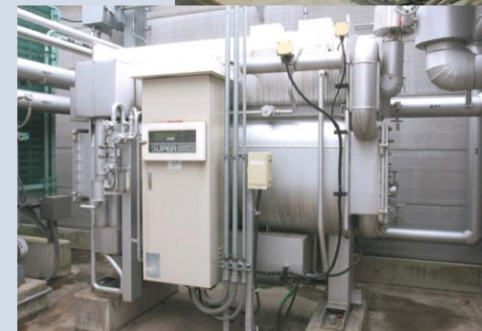
◀南館 低温水吸収冷凍機 (年間冷房用)
