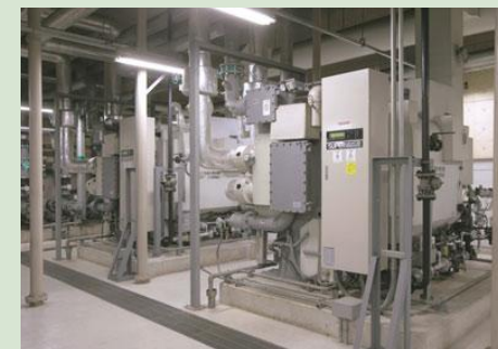
ガス吸収冷温水機(120RT×2台)
