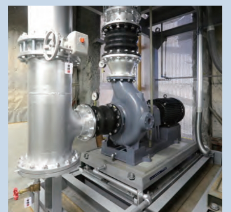
▲ 冷却水ポンプ
