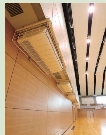
▲均等に配置された天井吊形室内機 (5馬力機種)
