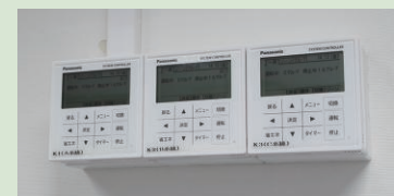
▲集中制御用システムコントローラー
