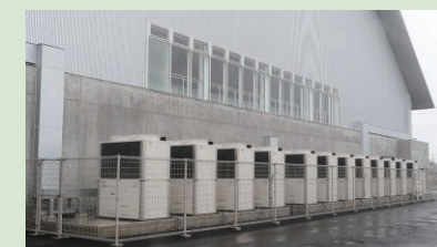
▲室外機(20馬力×12台)
