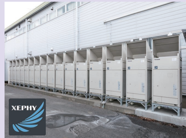
▲B棟工場の外に設置された室外機 PA-P560UXR5 CU-P280UXR5
