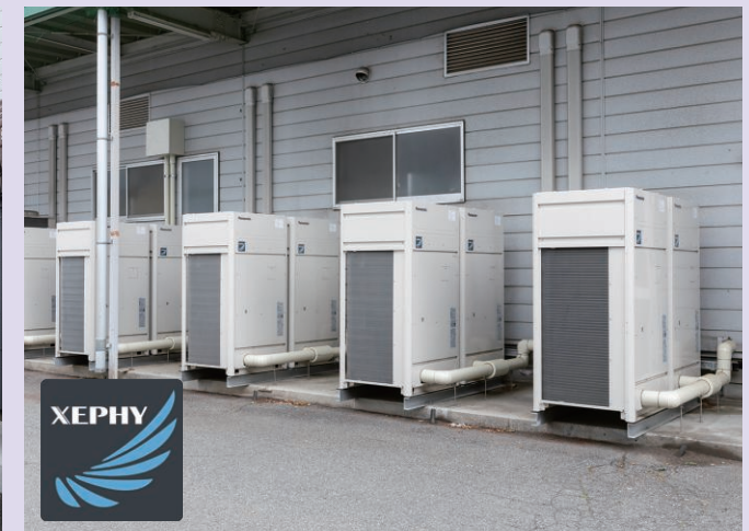
▲A棟工場の外に設置された室外機 PA-P560UXR5
