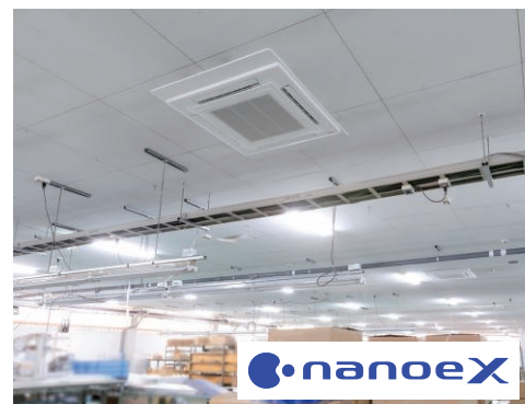
▲作業エリアに設置された 4方向天井カセット形室内機
