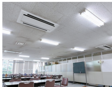
▲休憩スペースに設置された 2方向天井カセット形室内機
