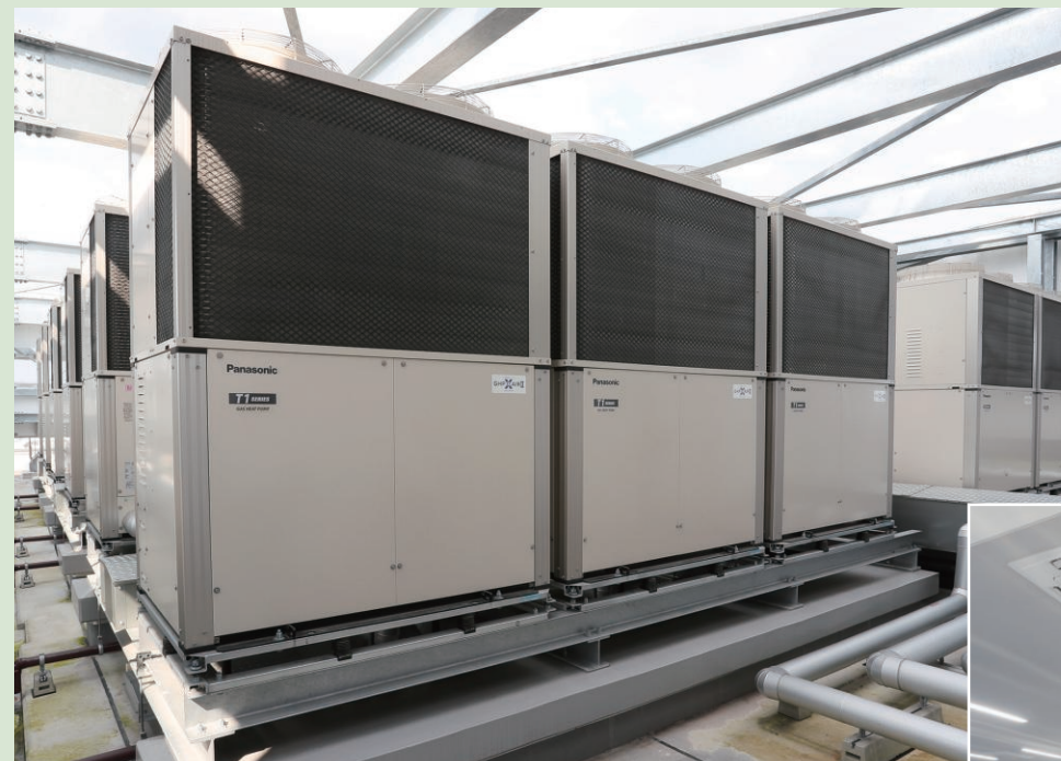
▲Wマルチ室外機 薬学部(21号館)を空調
