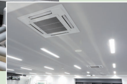
4方向天井カセット形 ▼(21号館実習室)
