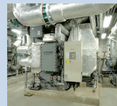
▲水族館 吸収冷温水機
