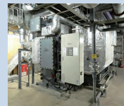
▲エントランスビル 吸収冷温水機
