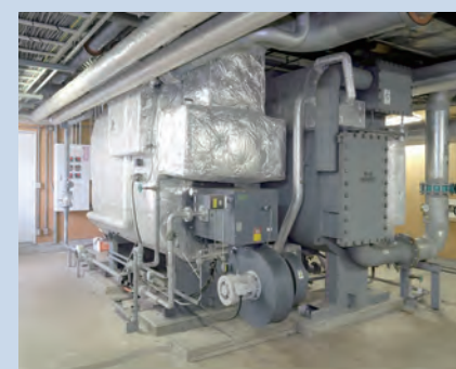
▲エントランスビル 吸収冷温水機
