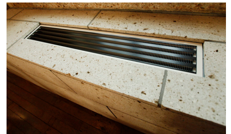
景観に自然に溶け込んだ吹出口
