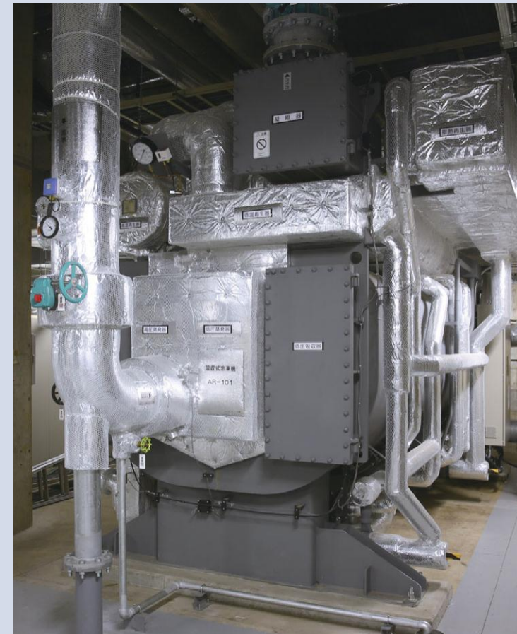
▲廃熱利用 蒸気焚きジェネリンク
