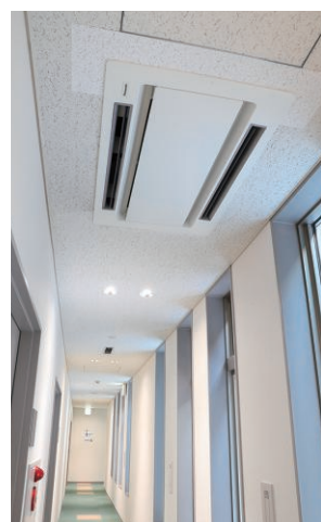
▲廊下に設置された2方向室内機
