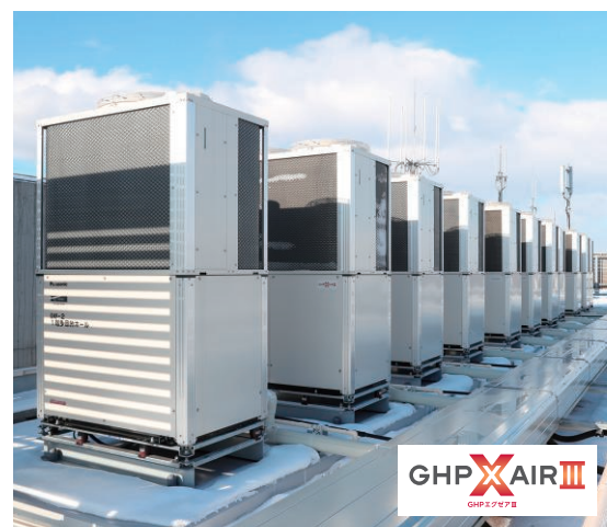
▲屋上に設置された室外機(エグゼアⅢ)
