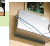
◀機械室内に設置されたクラウドアダプター
