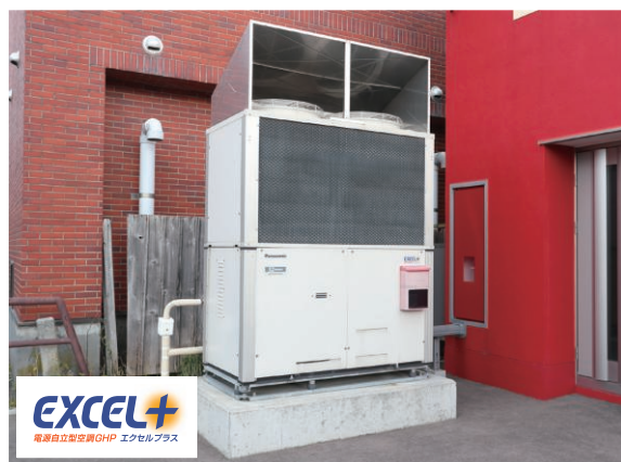
▲エクセルプラス室外機
