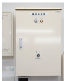
◀自立電源切替盤
