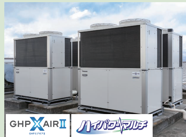
▲ハイパワーマルチ室外機(屋上)
