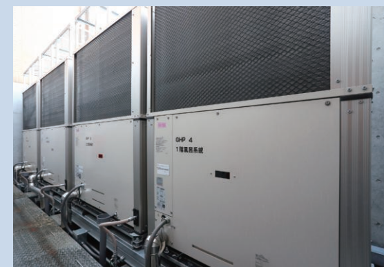
▲ガスヒートポンプエアコン
