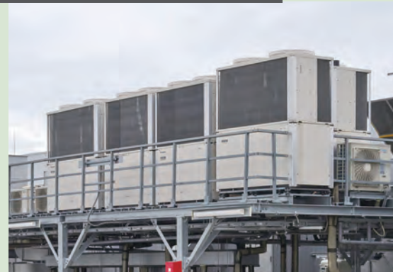
▲施設内の温熱環境維持にGHP200台が貢献する
