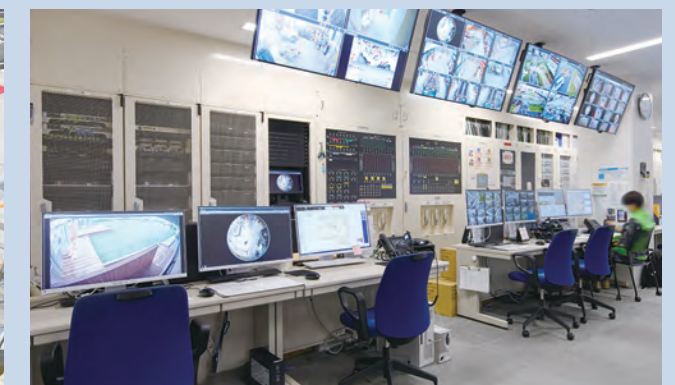
▲中央監視センター 空調制御を行い、館内の快適性を保つ
