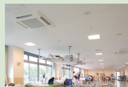
▲リハビリテーションルーム(4方向天井カセット形)
