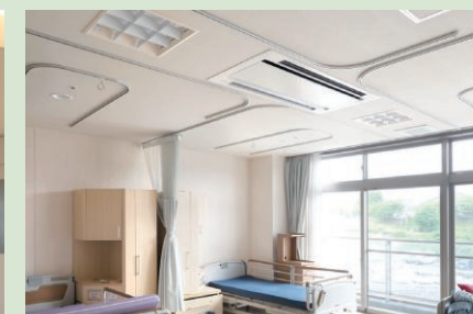
▲病室(2方向天井カセット形)
