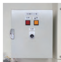
◀自立電源切替盤
