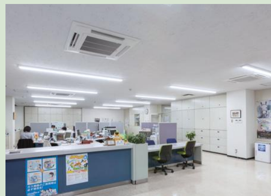
▲事務室・受付(4方向天井カセット形・照明)
