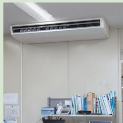
▲サーバー室(天井吊形・照明)
