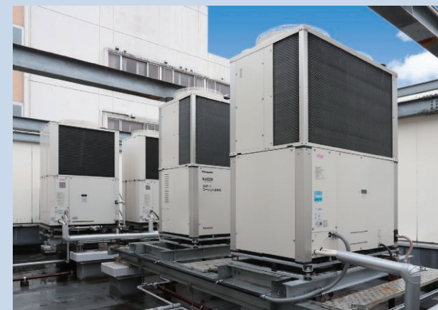
▲ガスヒートポンプエアコン
