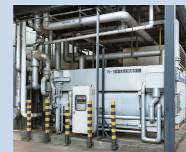
▲低温水吸収冷凍機
