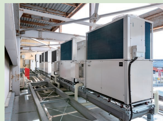
▲室外機(ハイブリット空調スマートマルチ)もご採用頂きました。
