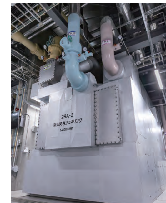
▲蒸気焚きジェネリック
