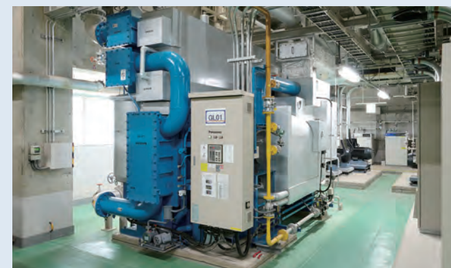
▲メインプラント(廃熱利用機)
