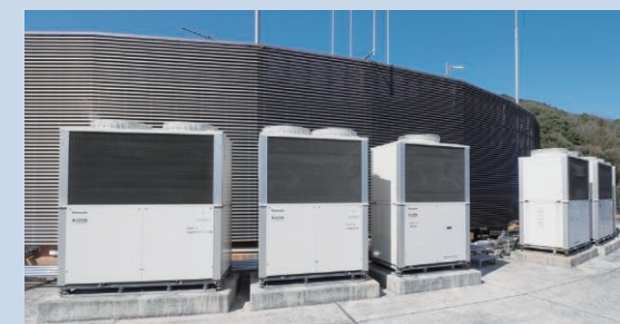
▲ガスヒートポンプエアコン
