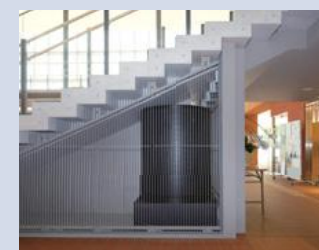
▲階段下のデッドスペースに 設置された空調機
