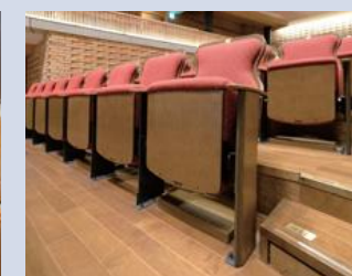
▲大ホール椅子下の吹出口
